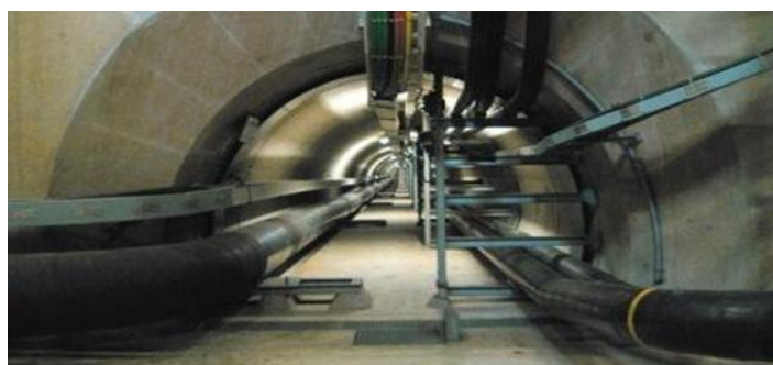
Afbeelding 6: een tunnel met gas- en elektriciteitsleidingen. 73
