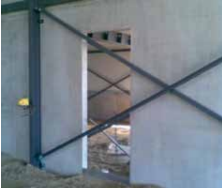
Figuur 1: Een voorbeeld van faalkosten: architect en constructeur hadden kennelijk een andere voorstelling van het gebouw en de situering van de doorgang 4
